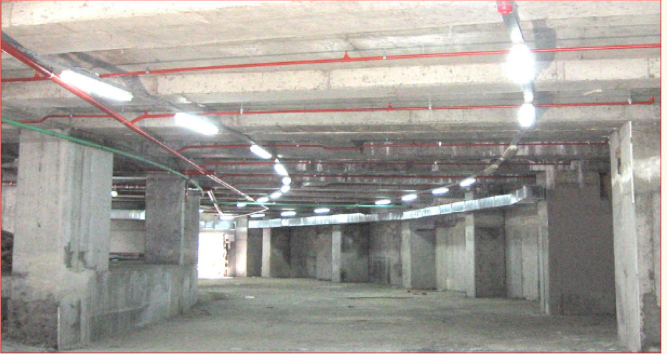
Kapalı Otopark'ın Yangın ve Havalandırma Tesisatlarından sonraki görünümü
